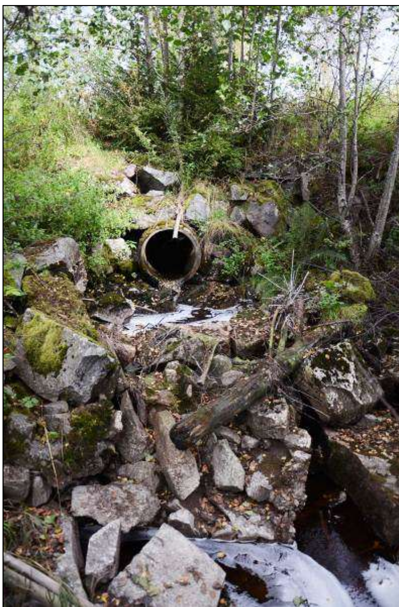
Figur 323. Vandringshindret med cementrör under vägbanken. Foto mot norr.
