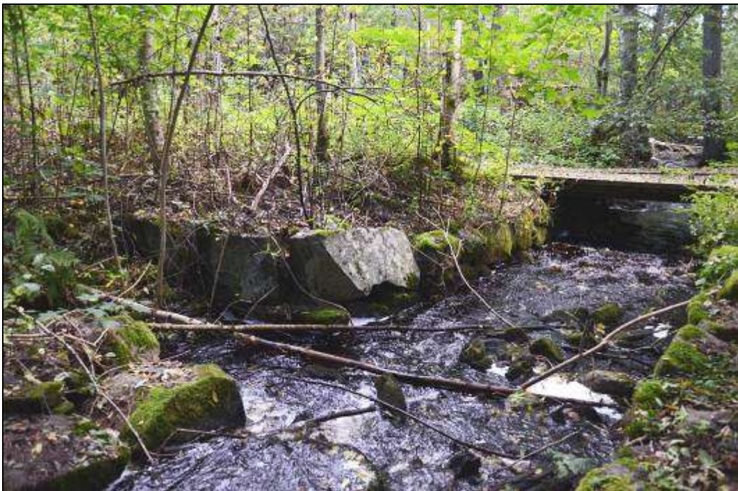
Figur 231. Stenskodd vattenränna nedströms dammvallen (Västervåla 43:1). Notera husgrund på motsatt bäcksida. Foto mot sydöst.
