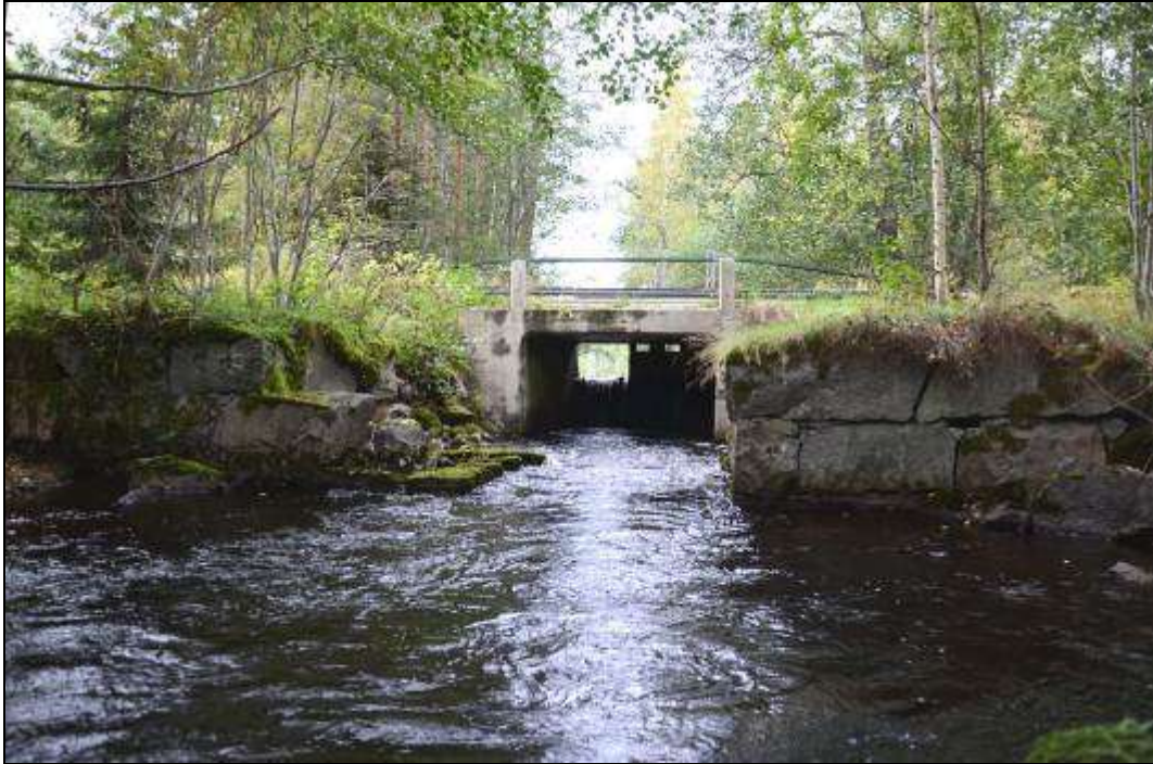
2.2.31 Figur 249. Två generationers broar vid Landfors hammare. På den översta stenen i bildens högra hörn finns en ristad datering: 1880. Foto mot N. Bockhammarsån och Erlandsbobäcken – vattenanknutna verksamheter
