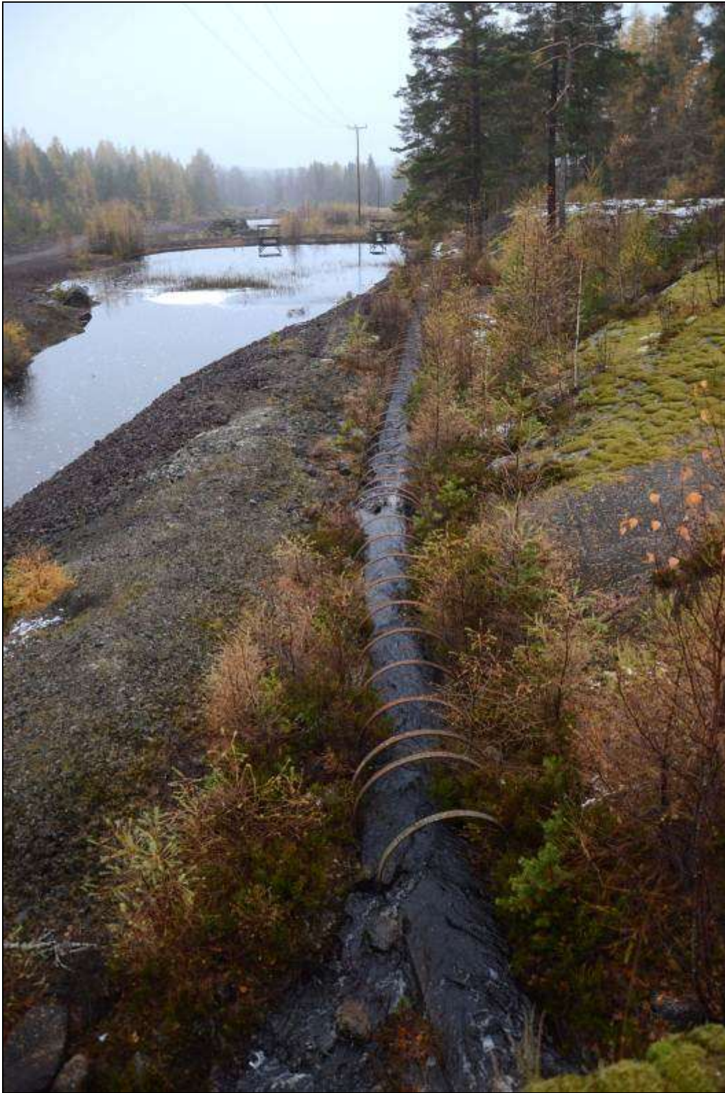
Figur 117. Rester av trätub från övre dammen till kraftstation. Foto mot söder.
