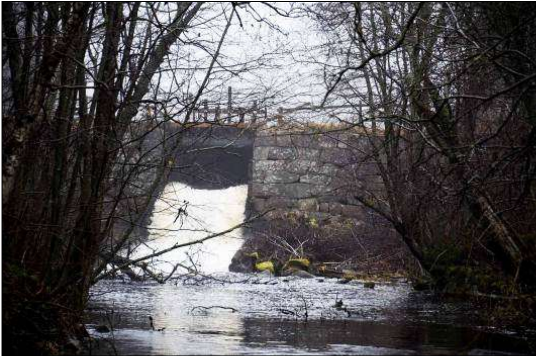
Figur 20. Det kraftiga vattenflödet i flodutskovet. Foto mot norr.
