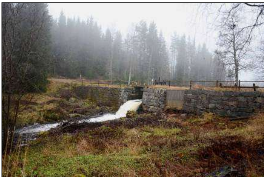
Figur 17. Dammen vid Korslångssmedjan. Foto mot nordväst. Notera det igensatta flottningsutskovet till höger på dammen.
