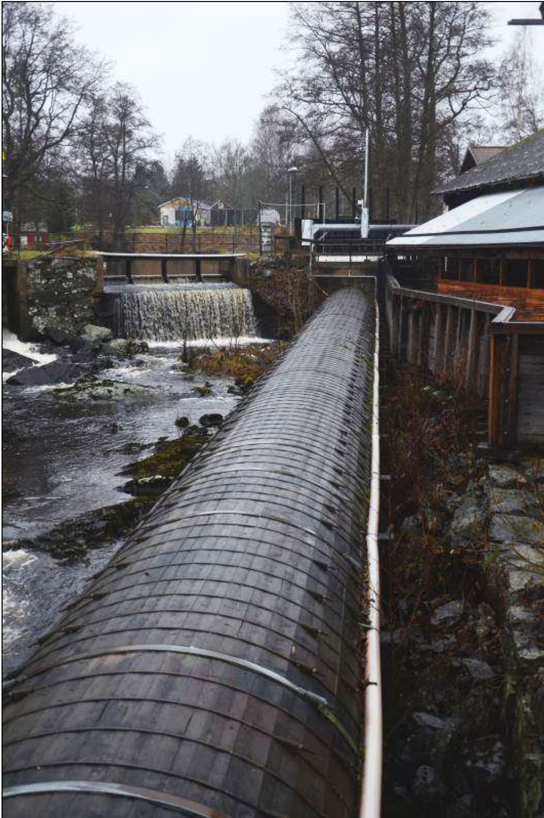
Figur 332. Vattentub i trä vid Karmansbo kraftverk. Foto mot nordväst.
