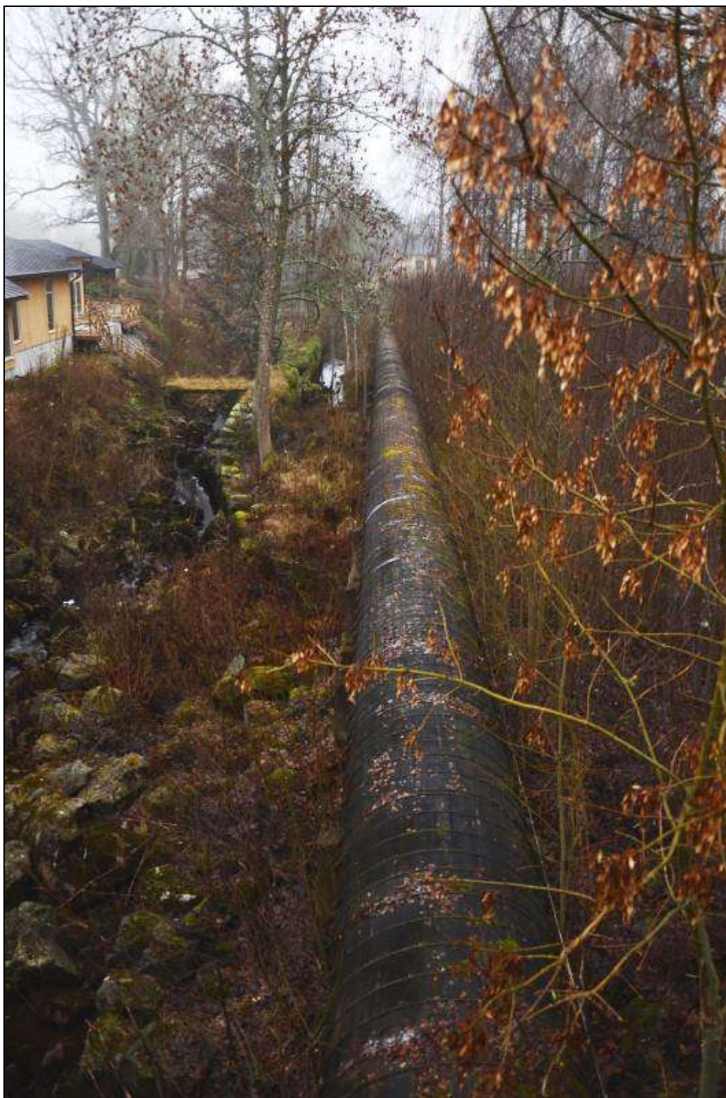
Figur 309. Från kraftverksdammen går en ca 200 m lång vattentub av trä ner till turbinhuset på föregående bild. Foto mot söder.
