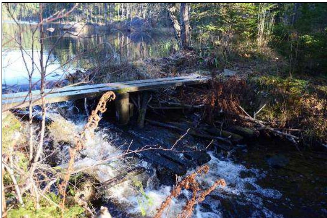
Figur 48. Dämnet vid sjön Lilla Håltjärns södra utlopp. Notera träkonstruktionen på skibordets botten.
